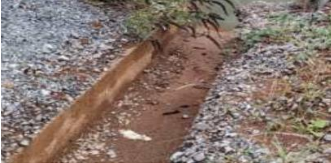
图5-5 项目雨水排水沟
