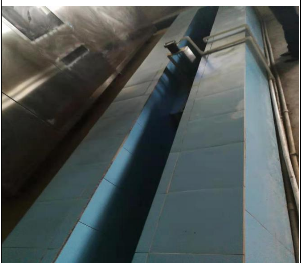
污水站出水计量槽
