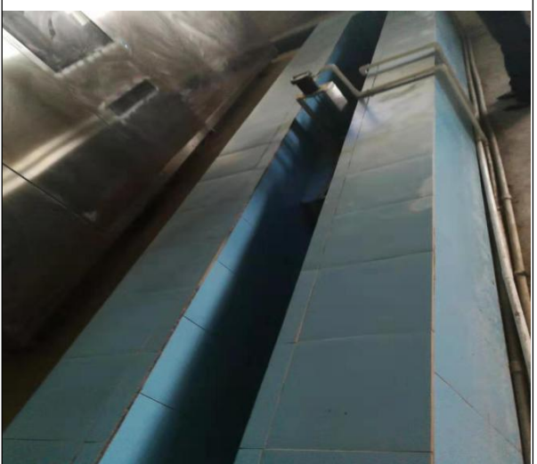
污水站出水计量槽
