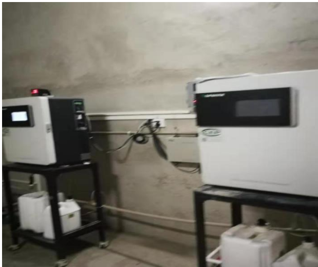
污水处理站在线监测装置
