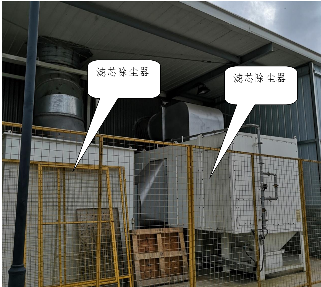
焊接烟尘处理设施图（滤芯除尘器）
