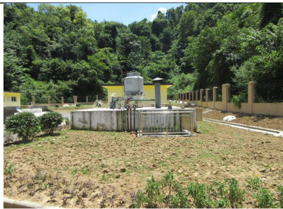
冷却循环水池及水塔
