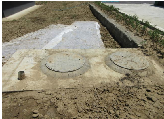
混装车清洗水隔油沉淀池
