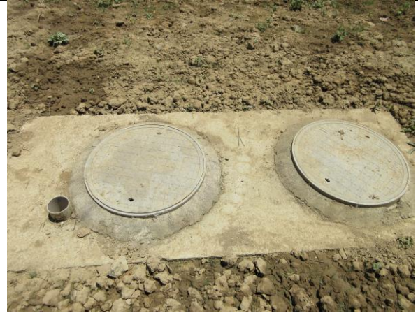
理化室废水中和池
