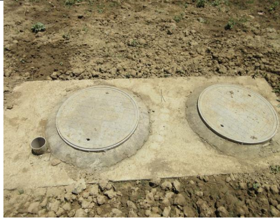
维修车间废水隔油沉淀池
