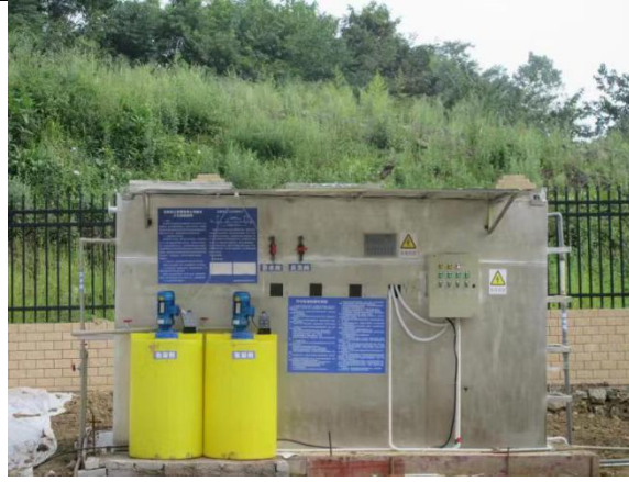
一体化污水处理设施
